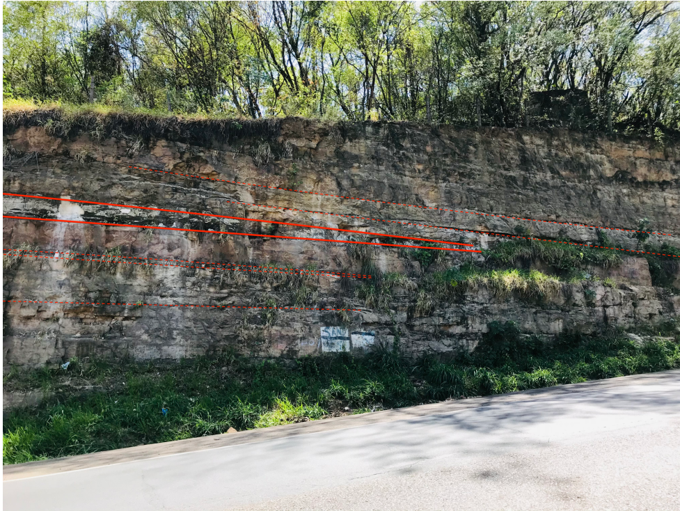
Figura 11. Perfil de talud en la que se puede observar las capas de arcillas en forma de cuñas de hasta 35cm de espesor y pequeñas capas intercaladas con la arenisca. Fuente: Elaboración propia
