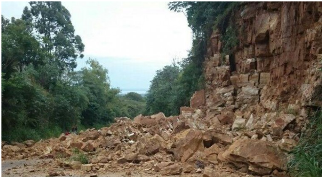
Figura 1. Un desprendimiento / deslizamiento de rocas que se produjo en la ladera del Cerro Caacupé, en 2017, cerró tramo de la Ruta PY 02 al tráfico durante varias horas. Fuente: Fotografía del Periódico Hoy
