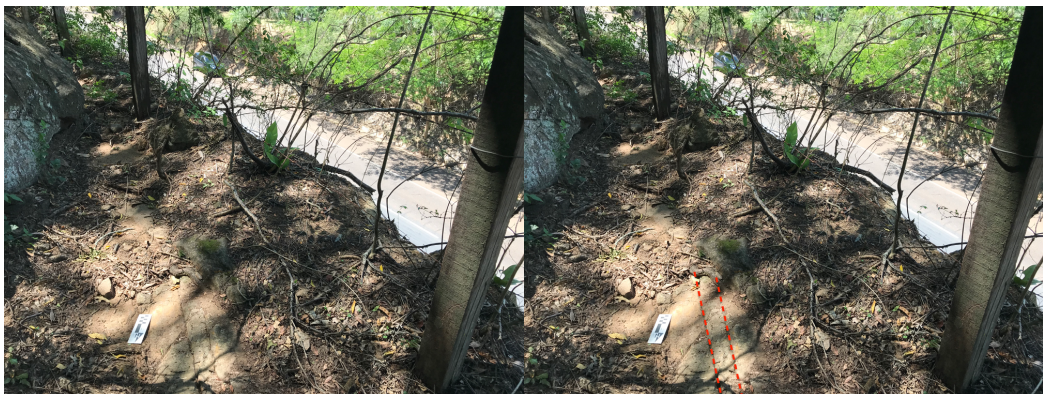
Figura 26. Fracturas en la cima del talud
