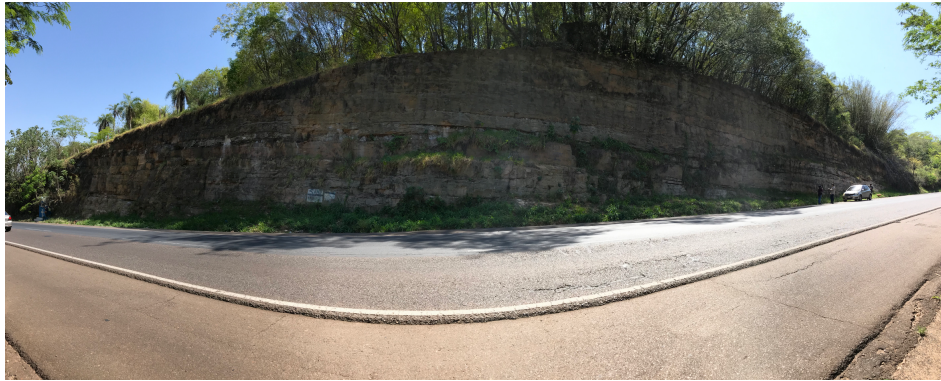
Figura 15. Vista panorámica del talud del Cerro Caacupé. Fuente: Elaboración propia
