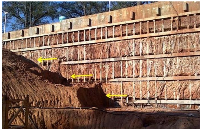
Figura 14: Pantalla de micropilotes de los edificios del World Trade Center Fuente: World Trade Center Asunción (Leoni & Asociados, 2012)
