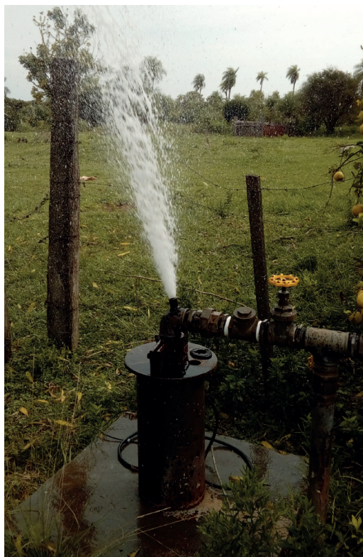
Figura 4 - Pozo con agua potable de Junta de Saneamiento en Pirayú.
