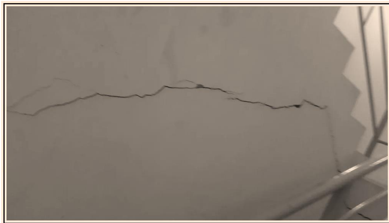
Figura 4. El temblor provocó fisuras en el edificio Citicenter. Fotografía: Antonio Holmes (22) .
